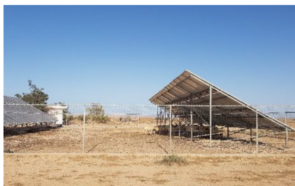
Vue d'ensemble de l'équipement photovoltaïque d'un forage à El Hamma à Gabes
