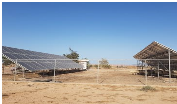
Station photovoltaïque de pompage d'eau
